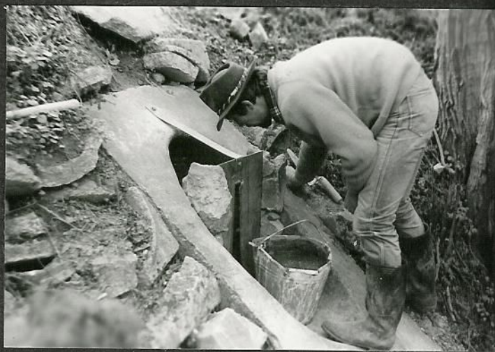
Bukóbeépítés hozamméréshez /Z/
