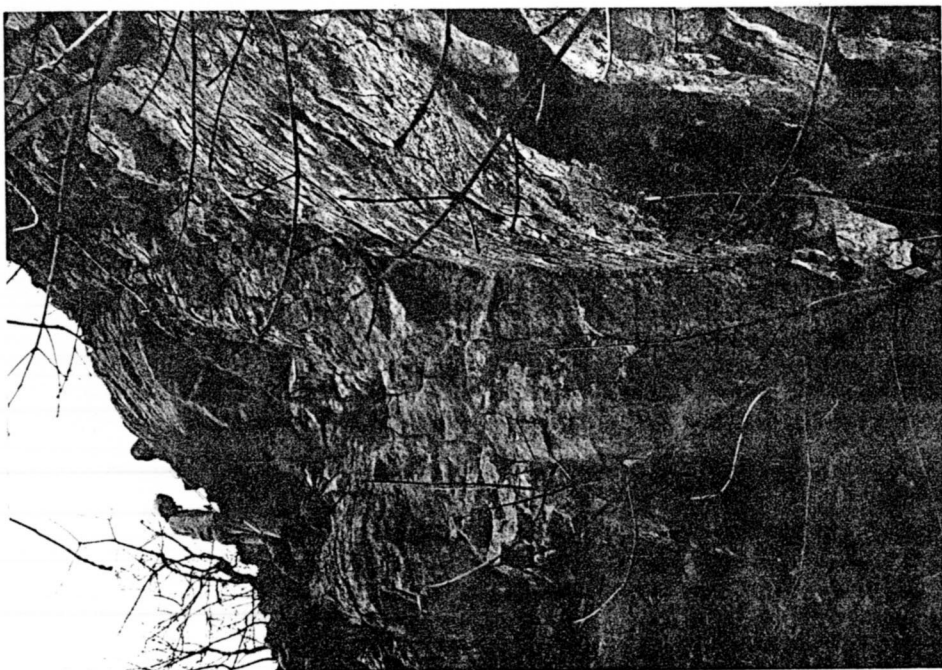
A LEHELŐS-LYUK - BARLANG BÉJÁRATA OMLÁSVEZÉLY, DE BELÜL IS INSTABIL A KITÖLTÉS!
