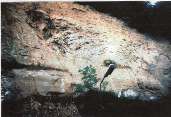
9. kép MÁV Somoskőújfalu vá. szakadófala eredeti állapotban (akésőbbi hálózás helye) 1999. aug.
