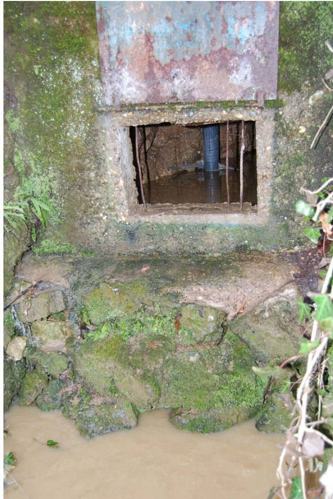
A februári áradás képei. A rakott kőfal bal felső sarkánál látható vízmegjelenés jelzi a fal mögötti, visszaduzzasztott víz szintjét
