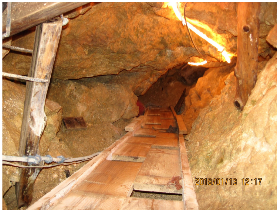
7. sz. fotó: A reményt adó, több részletben feltárt, nagyméretű kövekkel eltömődött 8m hosszúságú és 6,5 m mélységű lejtős akna, melynek bal alsó végében huzat irányában haladunk a műút irányában. A fényképen az akna bejáratába épített, vörösfenyő ácsolat és a mozgatható csúszdás-létra látható (fotó: kocsis János)
