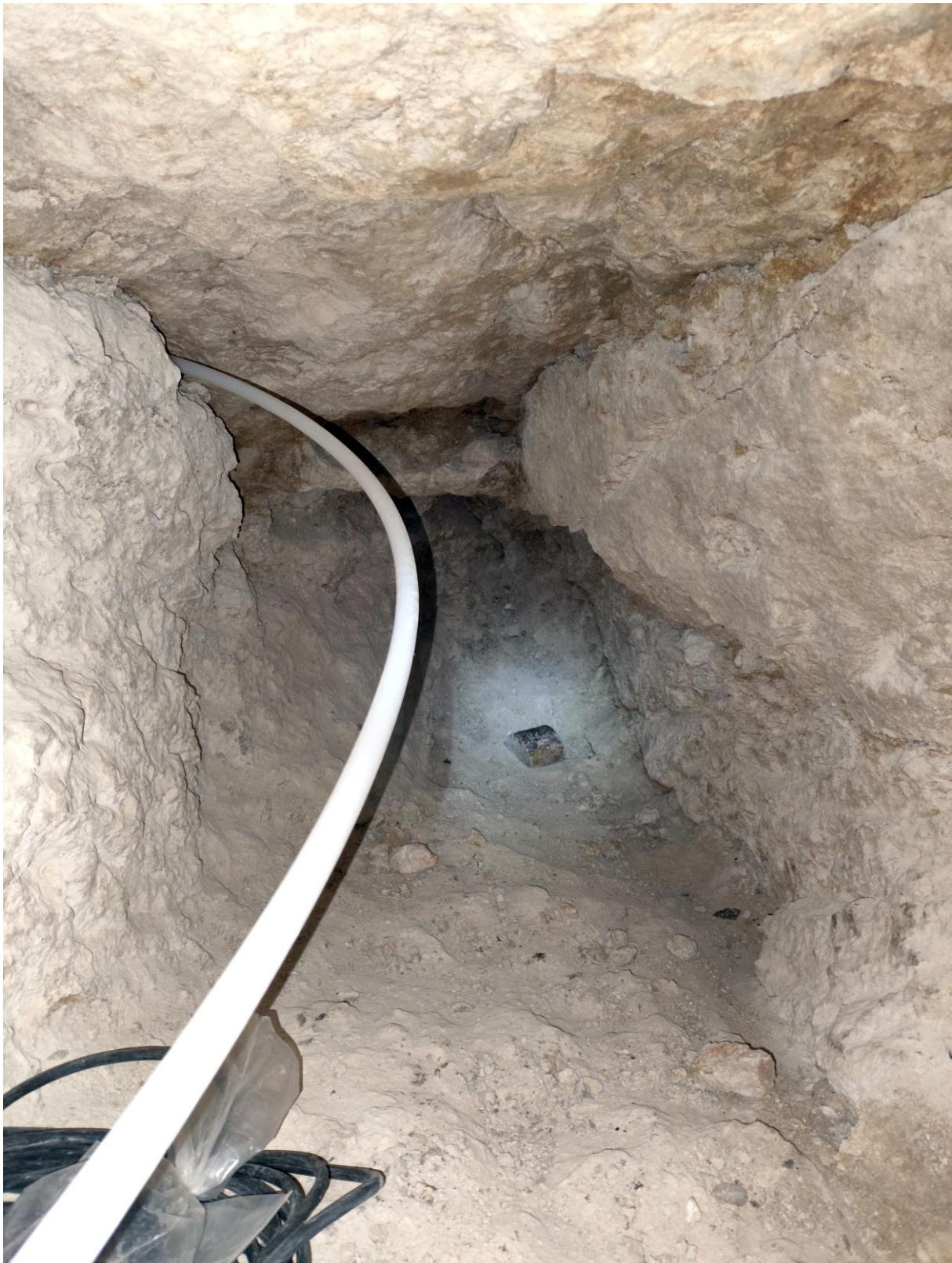
5. ábra Az elhasznált levegő elszívásához telepített cső és a villamos vezeték a végpont közelében (kép: Kocsis Gergely)
