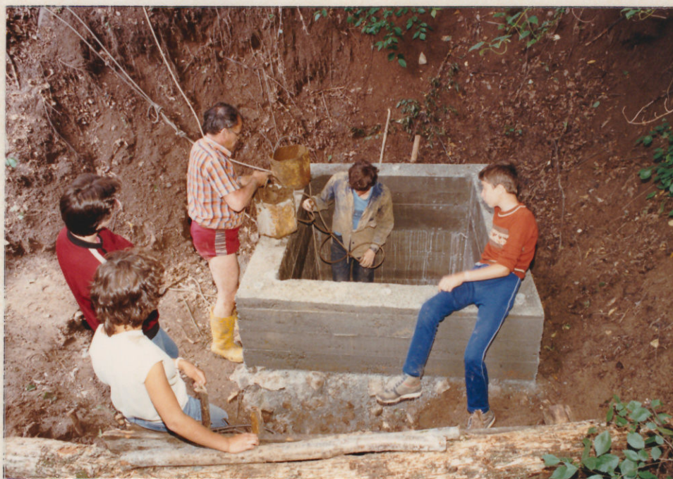
A Kuriszláni beszakadás omlásveszélyes bejáratát biztosító vasbeton szerkezet /fotó: Borzsák Péter/
