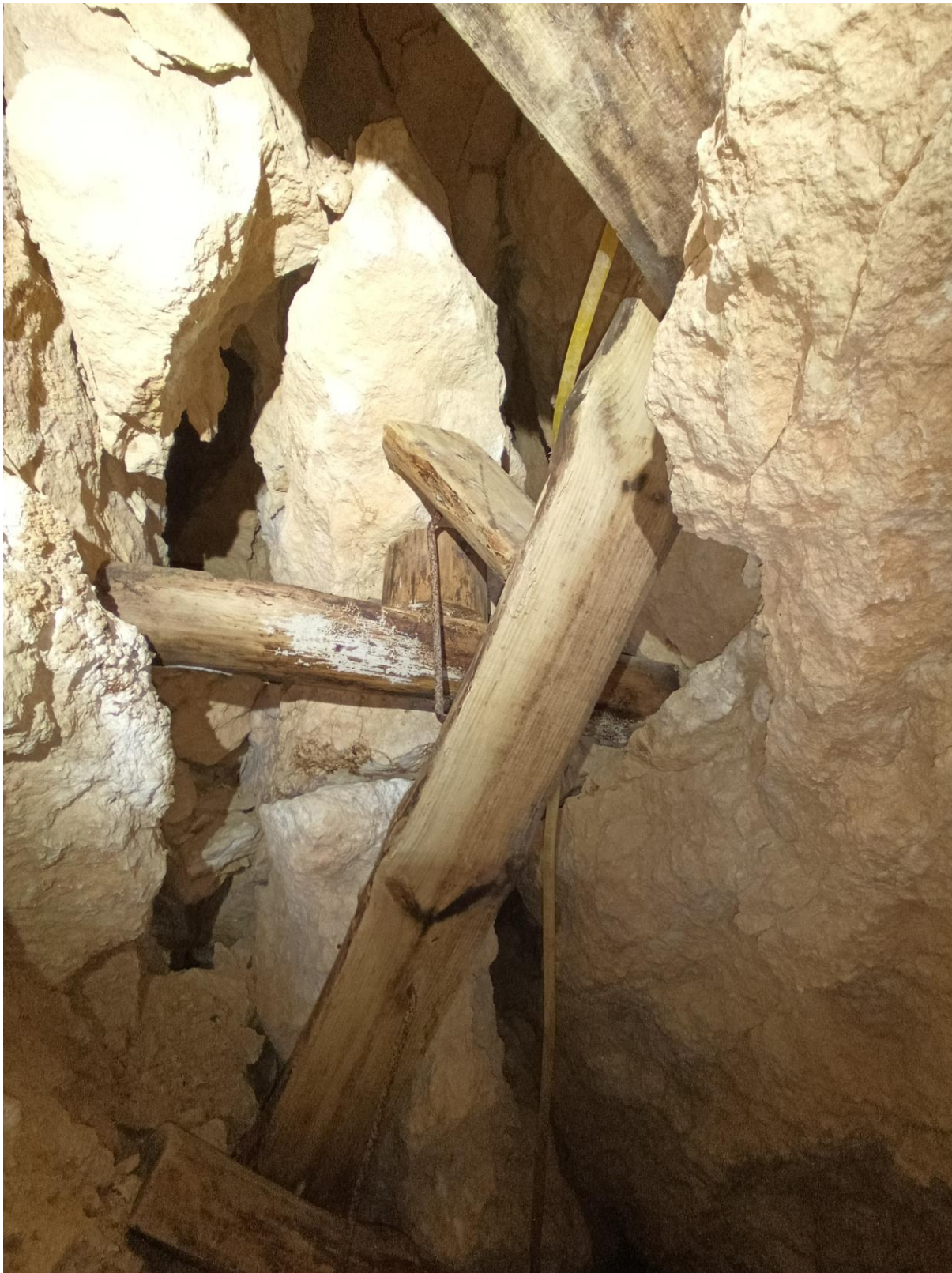
6. ábra A barlangban álló ácsolat állapota 2 (kép Finta Gábor)
