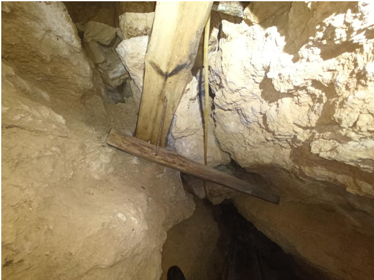
7. ábra A barlangban álló ácsolat állapota 3 (kép Finta Gábor)
