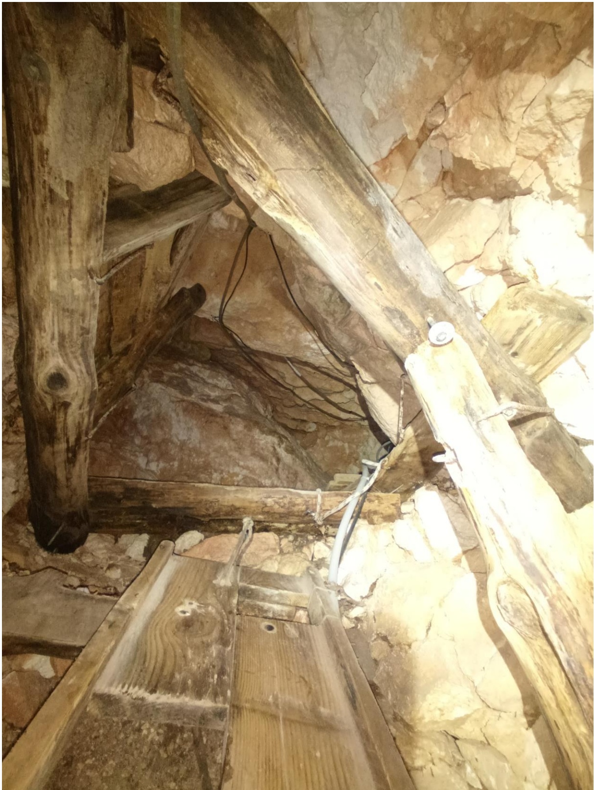
5. ábra A barlangban álló ácsolat állapota 1 (kép Finta Gábor)
