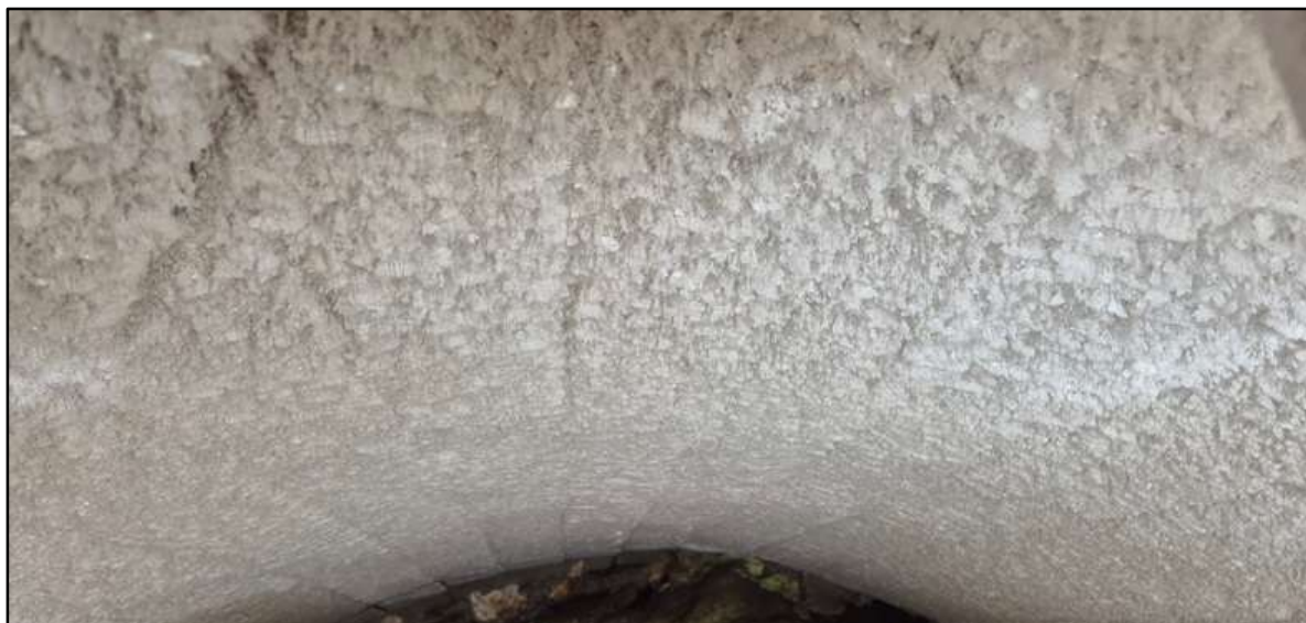
5. fotó. A bejáratban a betonföldre képződött, 5 cm vastag zúzmara, mely a kiáramló, páradús levegőből csapódott le.
